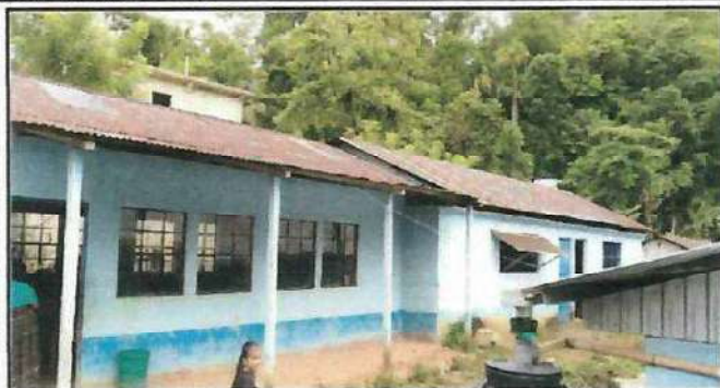
Foto 1: Se aprecia el mal estado de la cubierta de techo.
