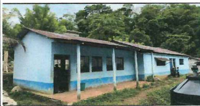
Foto 5: Se nota el poco mantenimiento en pintura en muro exterior.
