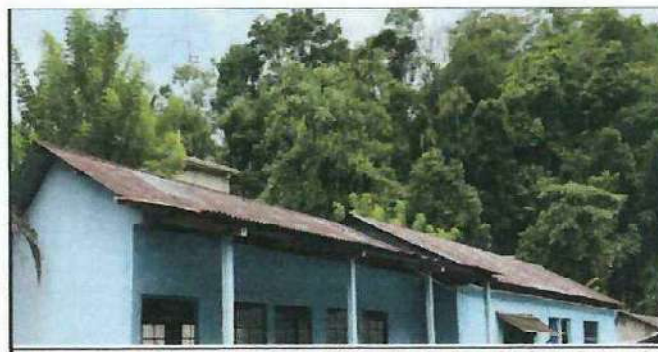
Foto 6: Se visualiza la poca ventilación de aula debido a la altura de pared.
