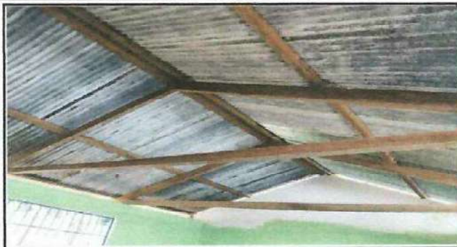
Foto 2: Se visualiza el mal estado de la estructura de techo por descomposición de la madera.
