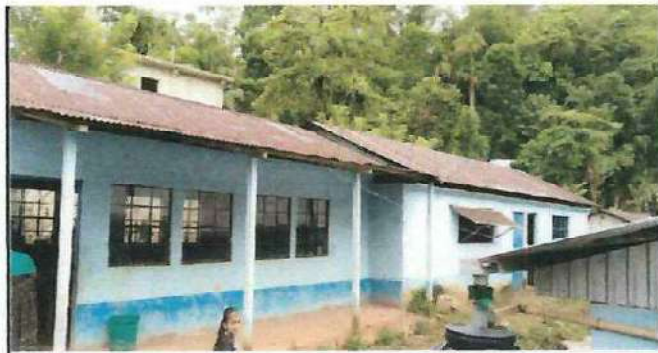
Foto 4: Se nota el deterioro y mal estado de muro de mampostería.
