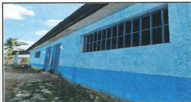
Foto 3: se visualiza la humedad de la pared debido a la falta de canales y bajadas de agua pluvial.
